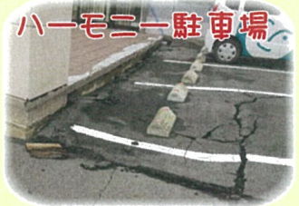
ハーモニー駐車場 敷地内のアスファルトは、地震により30cm あまり地盤沈下してしまいました。 全面バリアフリーだったのに…。(；_；)
